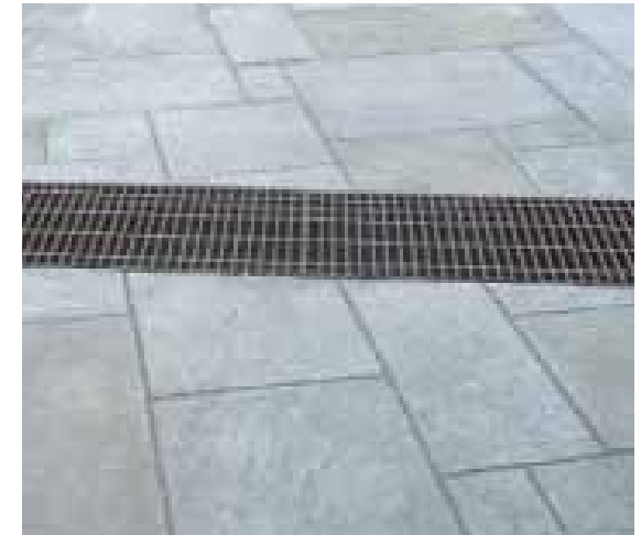
dwarsdrain in cortenstaal
